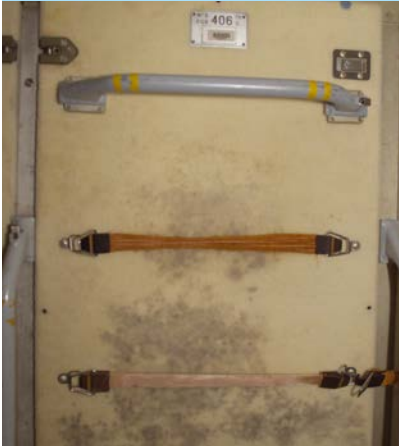
Hongos en la EEI, creciendo sobre un panel en el que se ha puesto a secar la ropa de hacer deporte.
